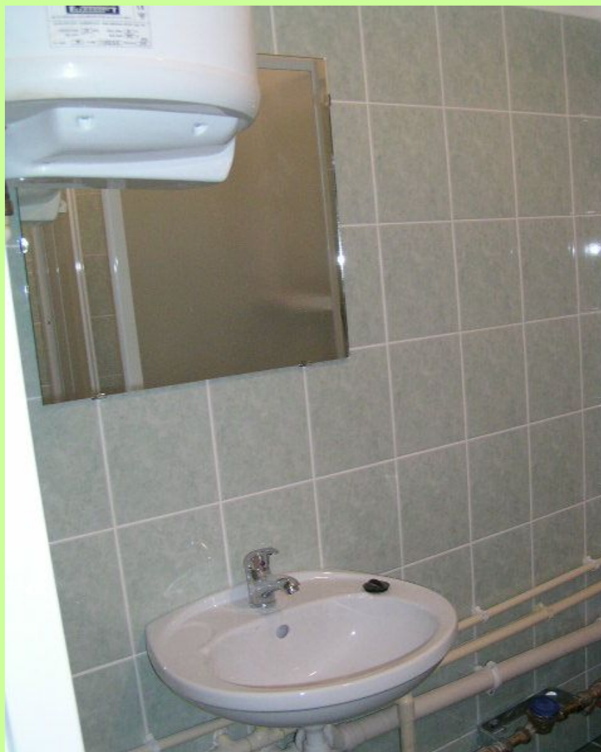
Łazienka (podgrzewacz wody, umywalka, toaleta).
